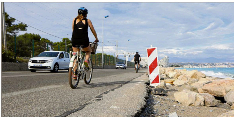
La RD6098 : la troisième voie routière et les places de stationnement déjà dévorées, la mer s'attaque maintenant à la piste cyclable.
